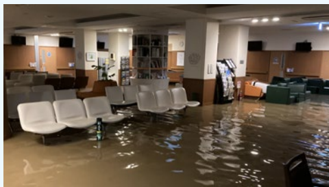
7/10(月) 浸水した病院一階外来待合室
